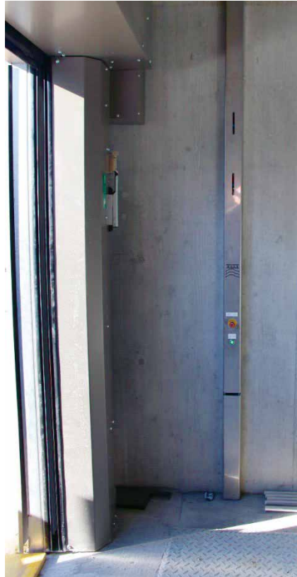
Bild 11: Die Höhenkontrolle für die beiden Höhenkategorien erfolgt bei der Einfahrt in die Übergabekabine über Lichtschranken; weiterhin wurden die Präsenzlichtschranken und Taster in den Verkleidungen installiert
