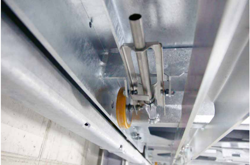
Bild 17: Robuste mechanische Konstruktion an den Parkpaletten mit einem Fallrohr, das mit einem elastischen Schlauch verbunden ist, über den das in der Parkpalette gesammelte Wasser in eine Sammelrinne abgeleitet wird, sobald sich die Palette an einer geeigneten Position befindet, wird das Rohr über die Rolle angekippt
