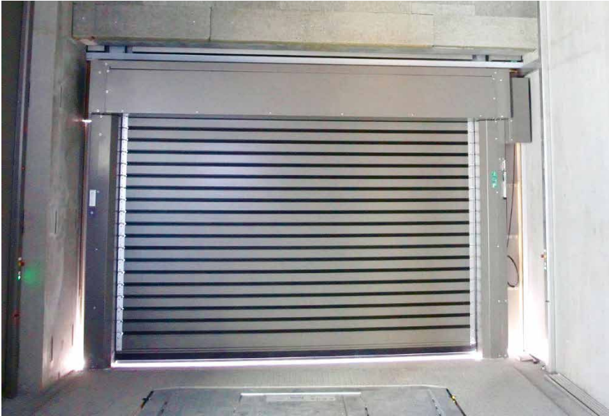
Bild 10: Spiral-Schnellaufotor im geschlossenen Zustand von innen; beiderseitig wurden grün beleuchtete Tor-auf-Taster installiert; die Lichtschranken für die Höhenkontrolle befinden sich seitlich direkt im Torbereich.
