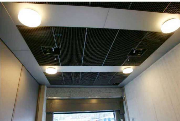
Bild 8: Deckenansicht der Übergabekabine mit Laserscannern für die seitliche Konturenkontrolle sowie die vom APS gesteuerte Innenbeleuchtung
