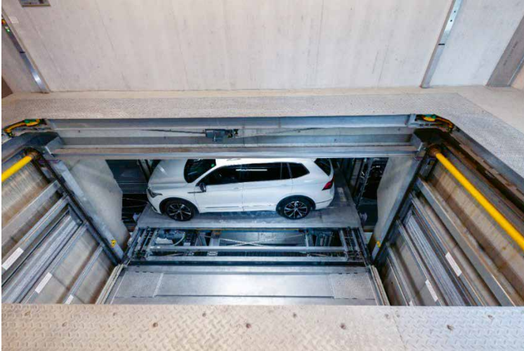
Bild 13: Blick in den Schacht des Vertikalförderers unter der Übergabekabine beim Palettenwechsel; in der Übergabekabine befindet sich gerade keine Parkpalette
