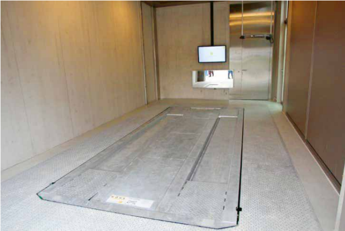
Bild 7: Blick in die leere Übergabekabine: im Ruhezustand ist grundsätzlich eine Parkpalette in der Übergabekabine als Absturzsicherung vorhanden, die auch verriegelt wird. In der Mitte hinten befinden sich ein Spiegel und ein Monitor, hinten rechts ist die Edelstahltür zur Schleuse in Richtung Foyer zu erkennen
